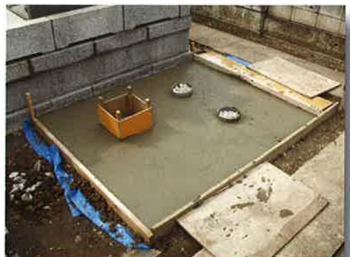
8) 基礎工事終了後、水抜き部分のシートをカットする。その際、D・BOX-Kを傷つけないように気をつける。
