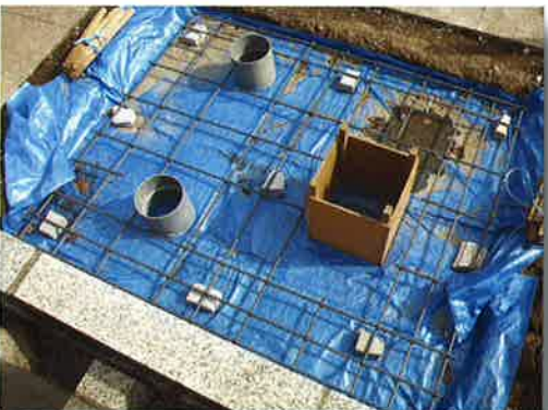
7) D・BOX-K施工後、ブルーシートを敷き、コンクリートがD・BOX-Kに流れ込まないようにする。
